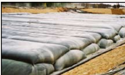
Dewatering dei fanghi estratti da un bacino a fanghi attivi di un'industria cartaria
