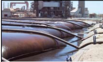
TenCate Geotube® impiegati per il dewatering delle ceneri volanti in un impianto di produzione di energia.
